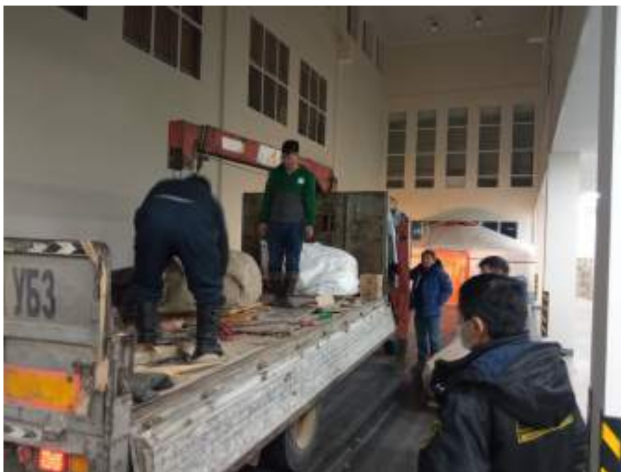
Зураг 15. Хэсэг байшингийн гэрэлт хөшөөний суурь мэлхий чулууг Соёлын өвийн үндэсний төвийн чулуун дурсгалыг сэргээн засварлах лабораторид буулгаж байгаа нь (2021.12.10-15)
