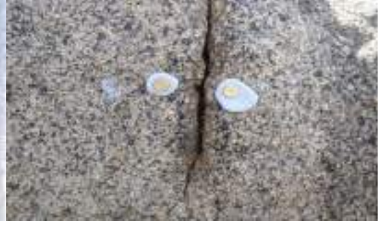
Fotoğraf 22: Çatlak oluşumu
